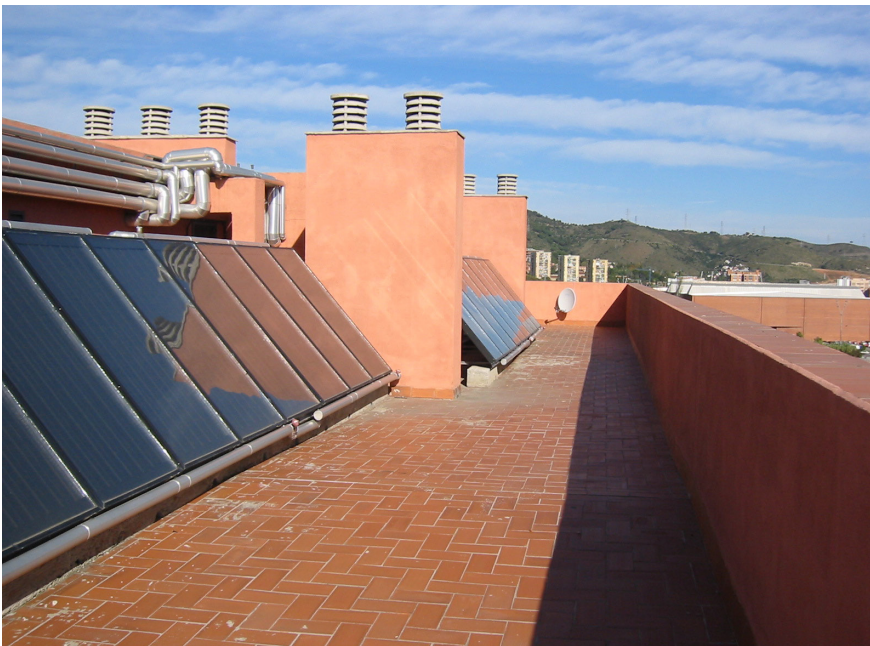
Imatge 25.. Instal·lació solar tèrmica. Font: Ajuntament de Barcelona
