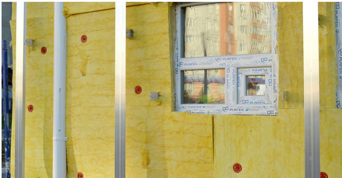
Imatge 7. Instal·lació d'aïllament tèrmic per l'exterior. Font: Image by Alina Kuptsova from Pixabay
