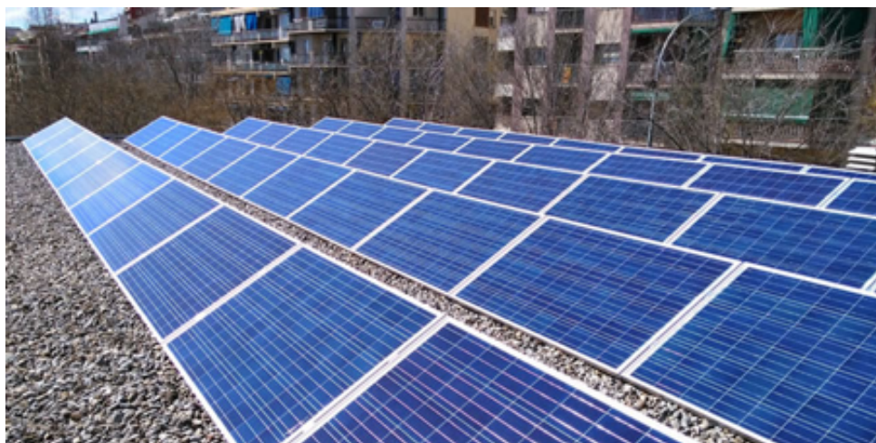
Imatge 24. Instal·lació solar fotovoltaica. Font: Ajuntament de Barcelona
