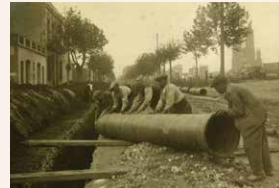
Colocación de tuberías de conducción de agua en los alrededores de la Sagrada Família, 1917. Archivo MUHBA
