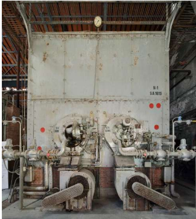
Caldera número 1 de la Sala de Calderes
