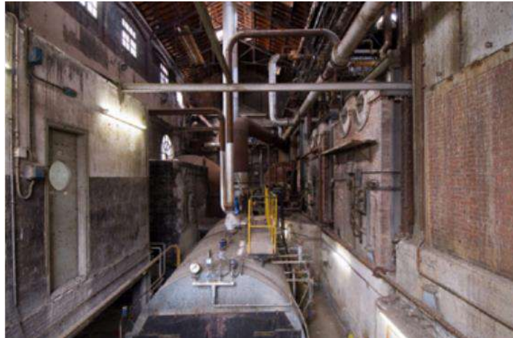
Caldera número 5 de la Sala de Calderes
