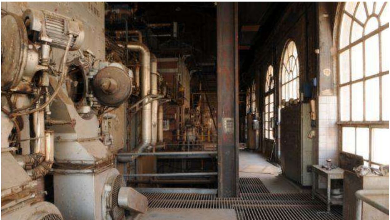
Vista interior de la Sala de Calderes
