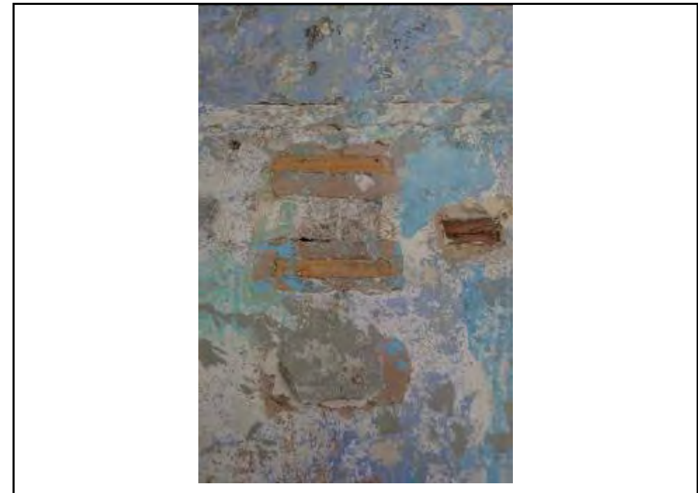
C4. Possiblement en aquesta part hi hauria la part del dipòsit o cisterna d'aigua per a la pica o sanitari
