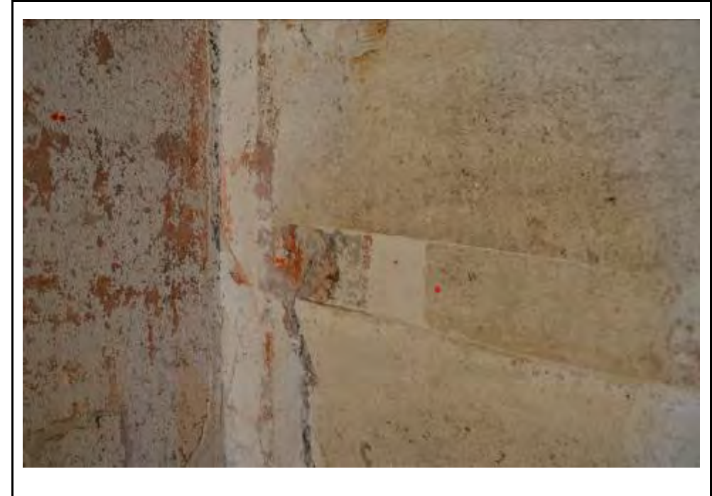
Cala 11 al mur B2
