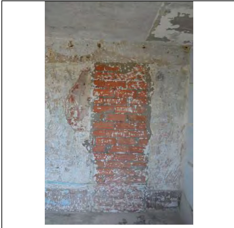
Porta tapiada, B3-O1, on és visible els totxos de 1980. Accés des del dormitori del capità al menjador i/o sortida a l'exterior
