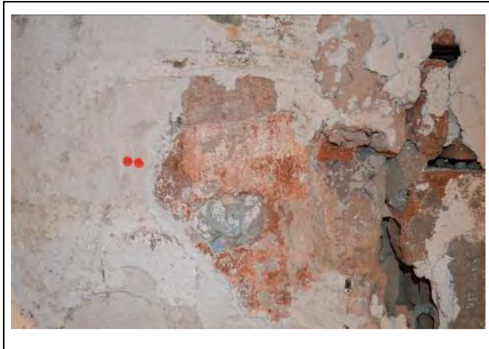
Cala 12 al mur B2
