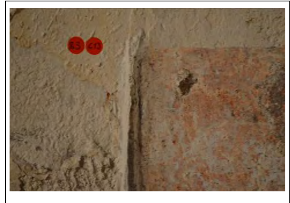
Cala 13 al mur B3
