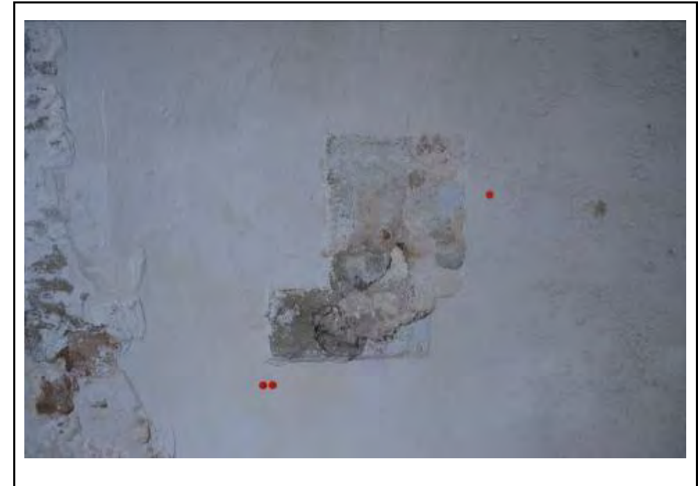
Cala 15 al mur C2. Realitzada per esbrinar les dimensions de l'obertura en aquest punt
