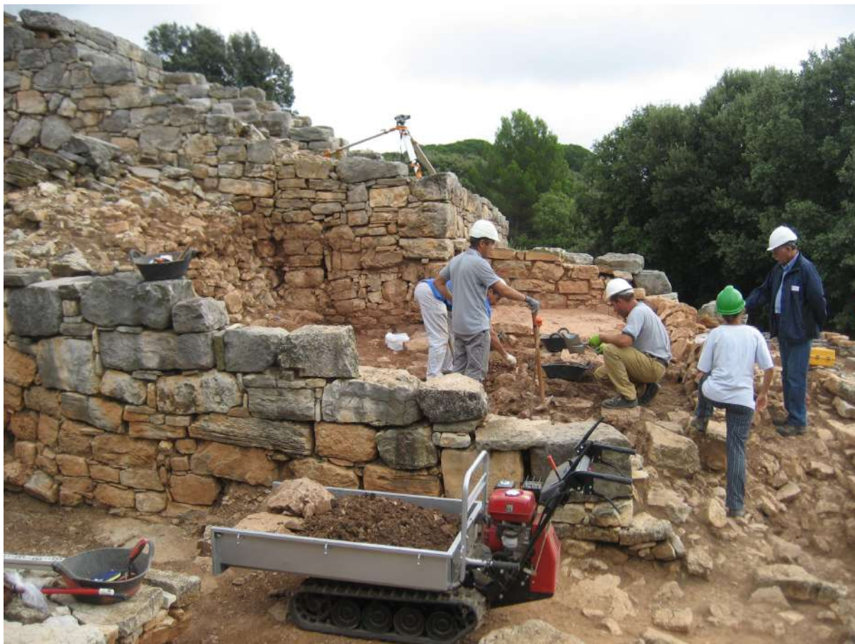
Fig. 2: Campanya d'excavació de l'interior de la torre 6 adossada a la segona muralla (Fotografia: Cecília Sanjurjo Marquine, 2014. Arxiu SPAL).
