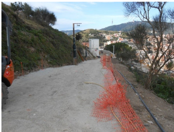
FOTO 35. Estat final de la part alta del carrer del Turó de la Rovira – Dormitoris de la Tropa
