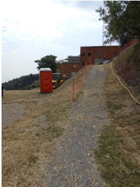
FOTO 31. Estat inicial del camí carrer del Turó de la Rovira – Dormitoris de la tropa
