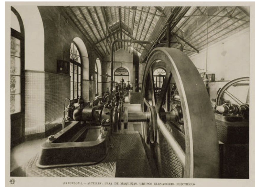
Casa de máquinas de distribución a alturas, Guinardó, grupos elevadores eléctricos, 1925, SGAB.
