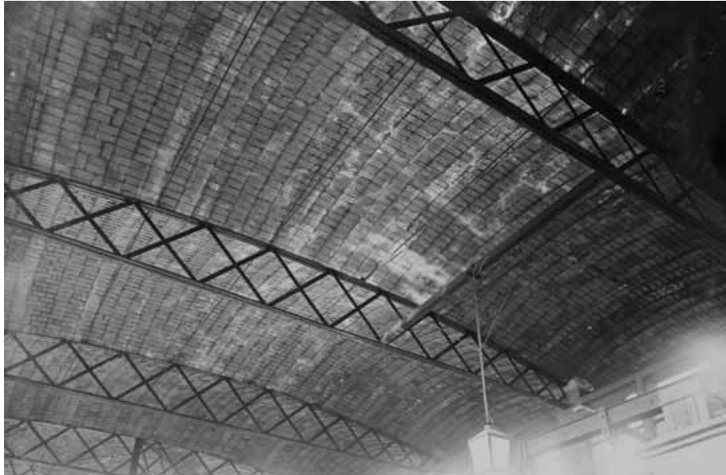
Taller de Can Torras dels Ferros a Poblenou cobert amb jàsseres de perfil parabòlic al cordó comprimit per rebre les voltes de maó pla (abans de 1910)
