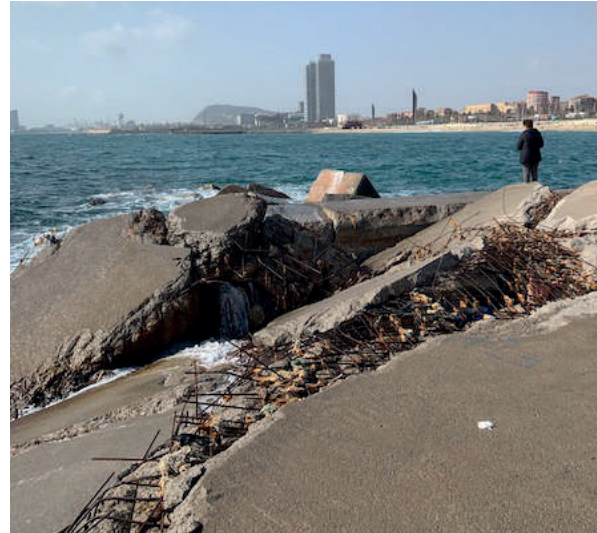
Imatge 23 Estat del espigó de la Nova Mar Bella
