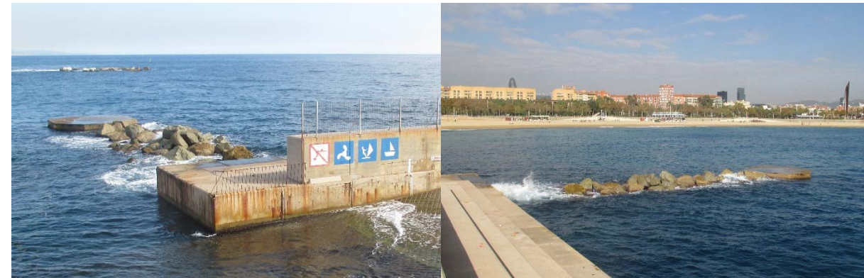
Imatge 36: Estat actual del dic de l'Escola de Vela
